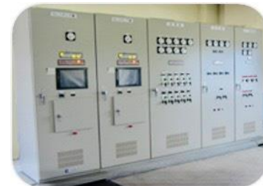
排水泵站 泵控制盘
