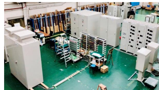
配电盘、控制盘组装工厂(A栋)
