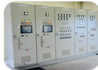
排水幫浦場 幫浦控制盤
