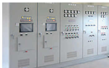
排水ポンプ場 制御盤
