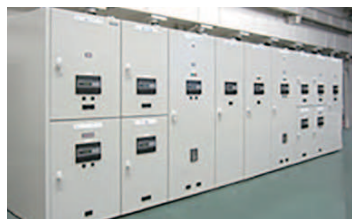
JEM1425 MW 高圧盤
