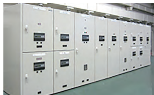
JEM1425 MW 高圧盤
