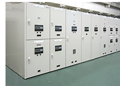
JEM1425 MW高圧盤
