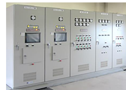
排水ポンプ場 制御盤
