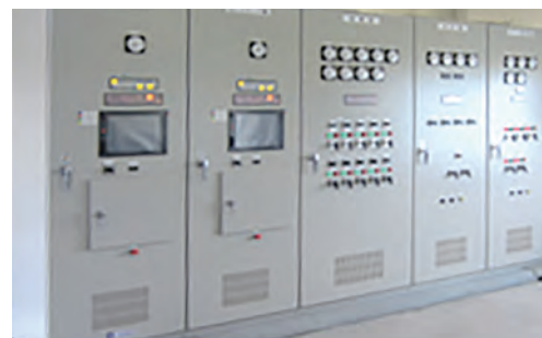
排水ポンプ場 制御盤
