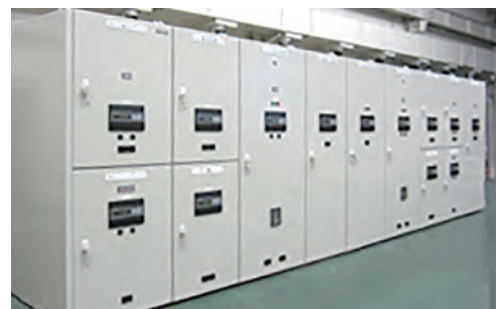
JEM1425 MW 高圧盤
